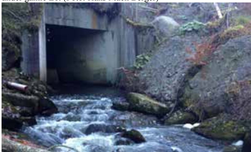
Figur 84. Kulvert ved Granheim er oppgangsbarriere for sjørret, og har et fall på ca 3 meter inne i kulverten. Stasjonsområde 15c er nedstrøms kulverten. (Foto: Hans Mack Berger)
