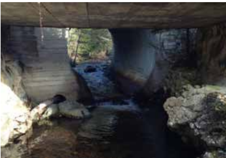
Figur 78. Kulvert under FV 963 i Lauva til Vikaelva. Passerbar for fisk i flere størrelser, men ikke optimalt utformet mht fall og vanddybde.
