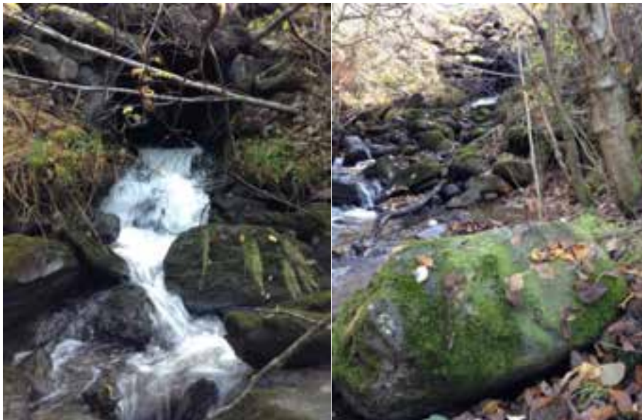
Figur 96. Krysning under Fv 941 i Fjølstadbekken til Vikhammerelva er utført på en lite egnet måte for fiskevandring. Inngrepet klassifiseres nå som en vandringsbarriere. Bildet t.h. viser otermarkeringssteinen like nedstrøms inngrepet, som indikerer at ørret er til stede i vassdraget. (Foto: Hans Mack Berger)
