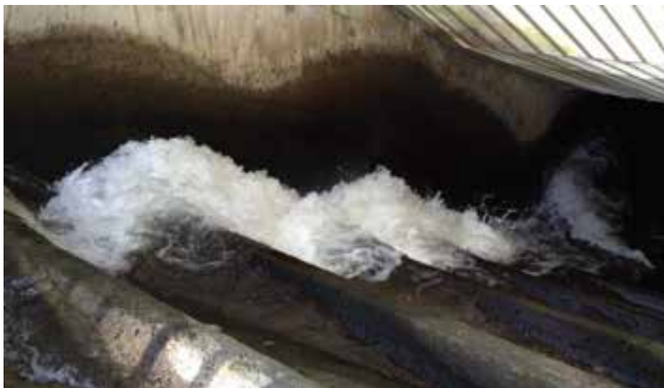
Figur 97. Uheldig konstruksjon for oppvanding av sjørret under dagens E6. Dette må utbedres ved anlegging av ny E6. (Foto: Hans Mack Berger).
