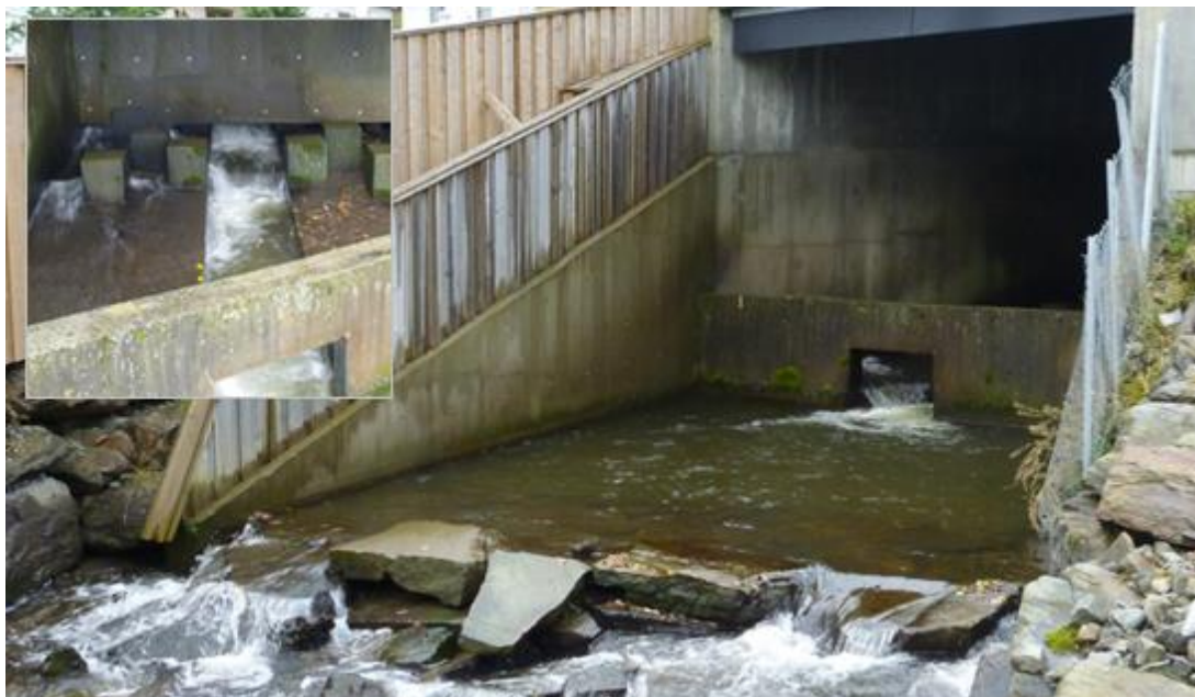
Figur 81. Nederste kulvert i Vikhammerelva ved utløp nedstrøms gamle E6. (Foto: Morten Andre Bergan).
