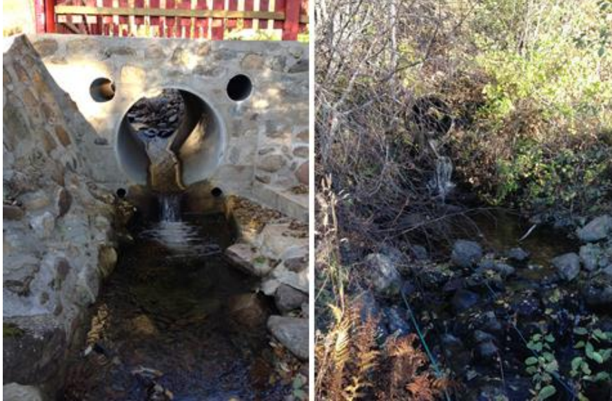
Figur 63. Kulvert under privat vei (t.v.) og under Fv 926 (t.h.). (Foto: Hans Mack Berger).
