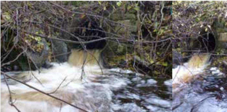
Figur 50. Kulvert under Fv 705 i Evjebekken er sterkt vandringshindrende eller vandringsbarriere. (Foto: Morten Andre Bergan).
