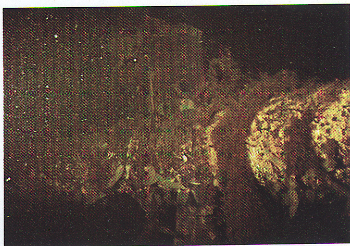
Fig. 78. Slamansamling ved ende av utløpsledning.
