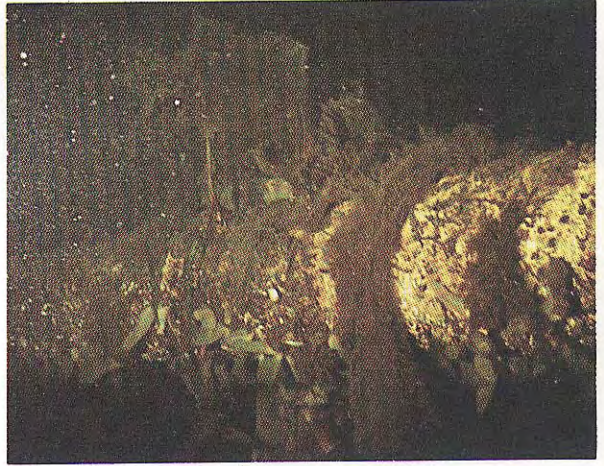
Fig. 78. Slamansamling ved ende av utløpsledning. ←
