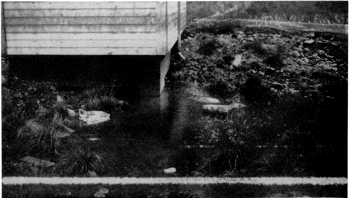
Dårlig rensed avløpsvann danner stor dam på utsiden av anlegget.
