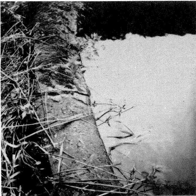
Hev- og senkbar utløpsterskel som ikke fungerer. Vann og slam går ut hele tiden mens luftingen pågår.
