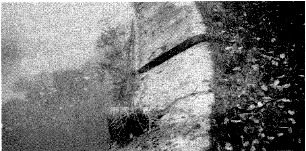
Sprekker i kanalveggen kan gi ukontrollert avløp.
