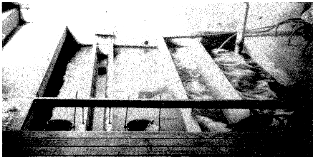
Luftetank (til høyre) og sedimenteringstank (til venstre).
