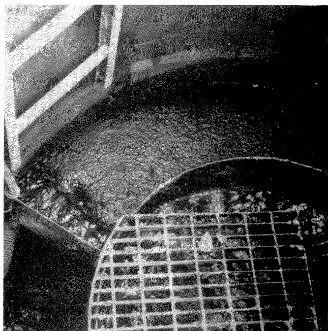
Flyteslammet i sedimenteringstanken går rett i utløpet. Hele overløpsrennen er ca. 40 cm lang.
