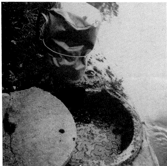
Slamkum for uttak av overskuddsslam, evt. intermitterende returslampumping.
