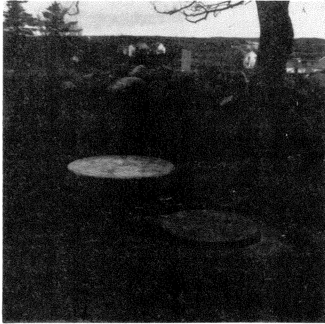
Malmheim skoles renseanlegg. (De to kumlokkene).
