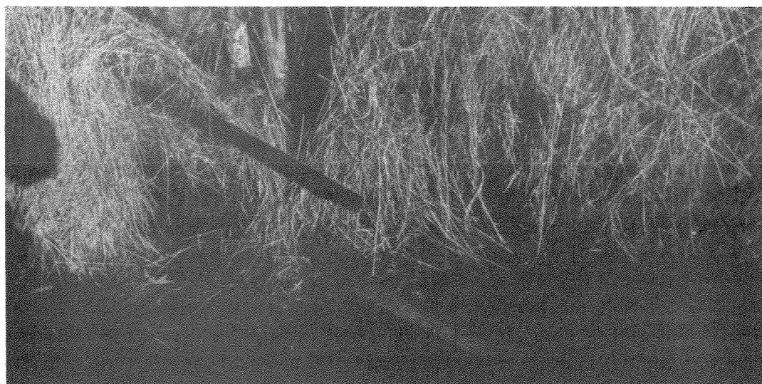
Utløpsledningen fra anlegget var kappet over slik at avløpsvannet rant ut i en åpen grøft.
