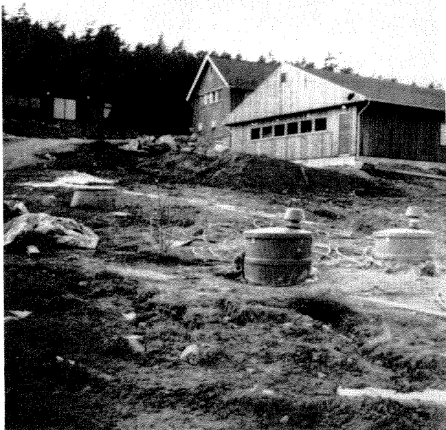
Lilleng renseanlegg (de to Flygt anleggene i forgrunnen).
