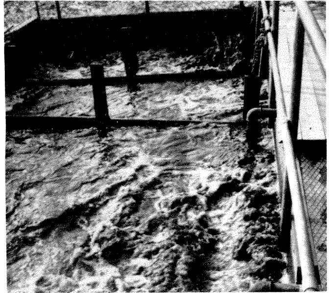
Luftetanken med det provisoriske flokkuleringskammeret ved innløpet til sedimenteringstanken.
