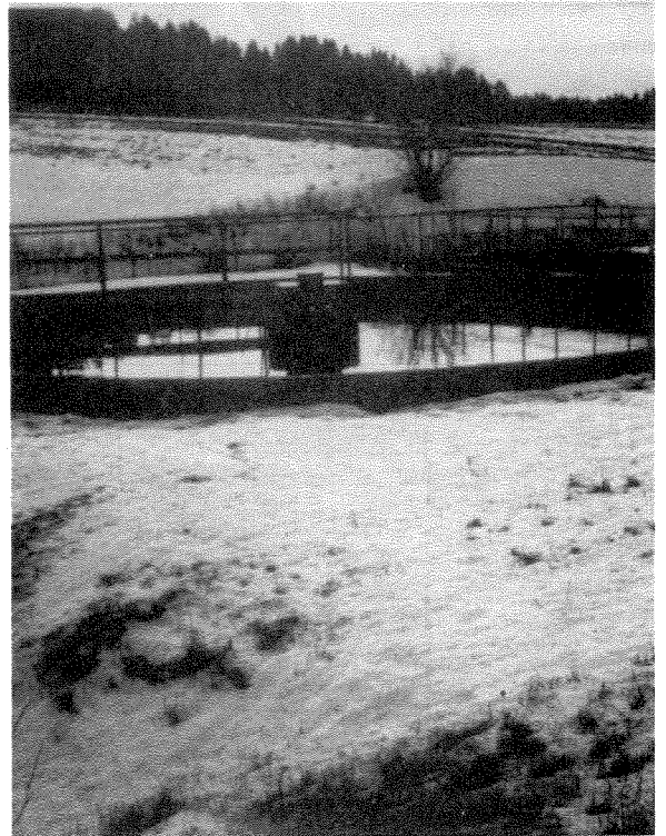
Sedimenteringsbassenget var ikke overbygget.
