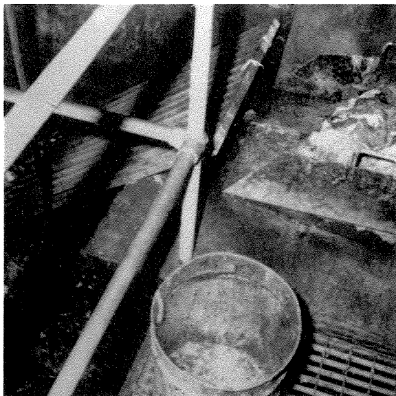
Risten har for stor stavavstand og fordelingen av avløpsvannet til de to luftetankene er for dårlig.
