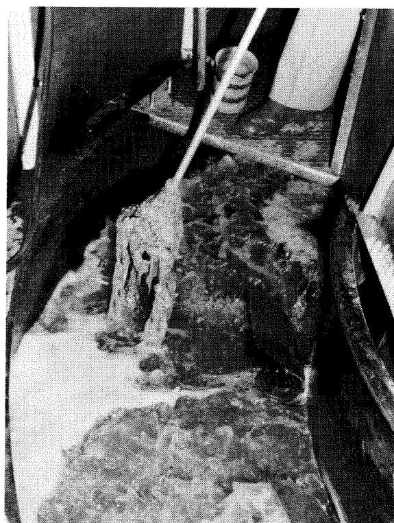
Utilstrekkelig tilbakeholdelse av filler i innløsryst forårsaket akkumulering av disse i luftetank og problemer med omrøring. Bildet viser også en mammutluffer som er ute av funksjon.
