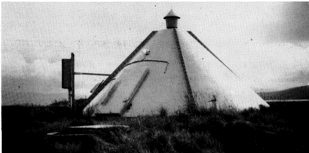
Evenes Lufthavn's renseanlegg.
