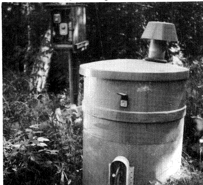
Både automatikkskapet og lokket på renseanlegget manglet lås.
