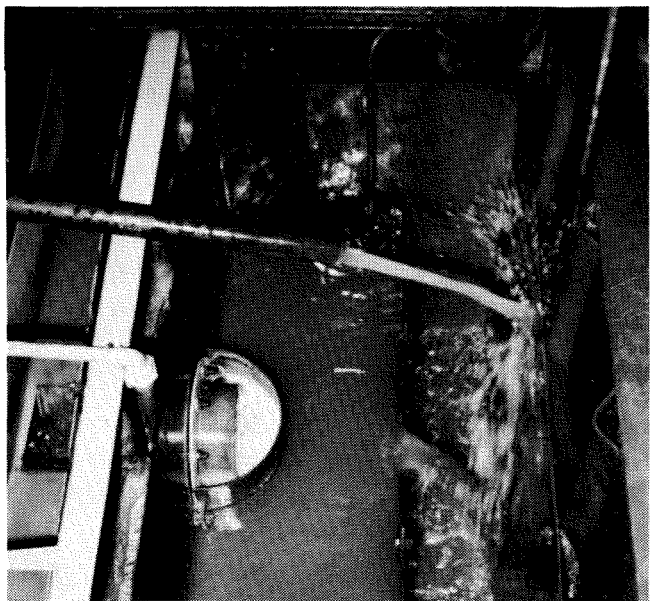
Utløpskassen med røret fra flyteslamavdragene øverst. Dette må ikke ledes til utløpet av rensanlegget.
