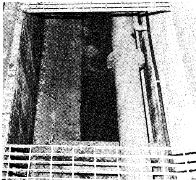
Anlegget var tungvint å holde rent. F.eks. i denne rørkanal mellom sedimenterings- og luftebasseng samlet det seg skitt som var vanskelig å få fjernet.
