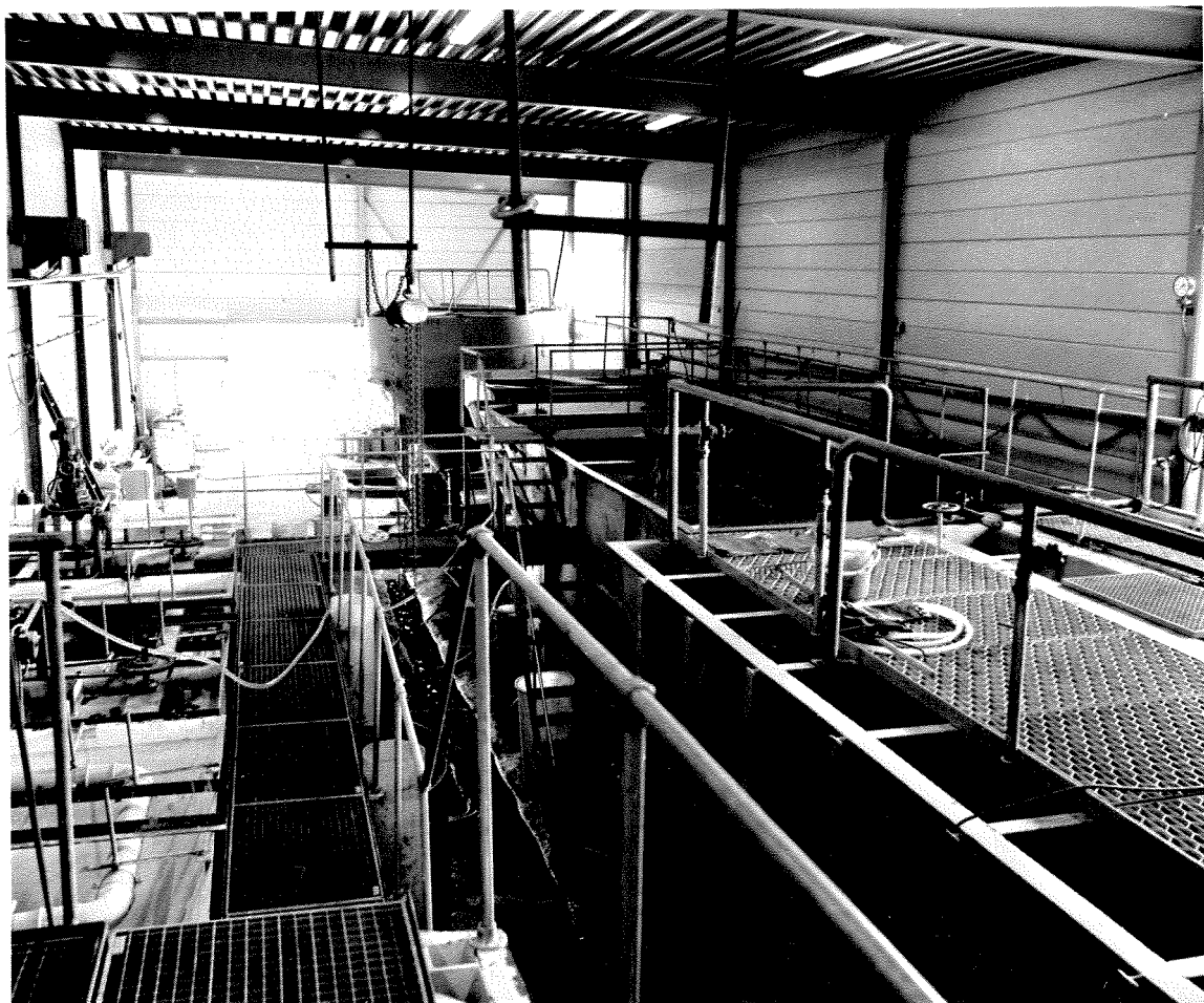
Fig. 12. Forsøkshallen med rensetekniske anlegg for kommunalt avløpsvann ved NIVAs Forsøksanlegg på Kjeller.
