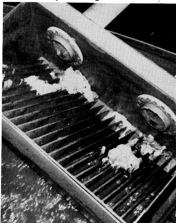
Innløpsledning med rist
