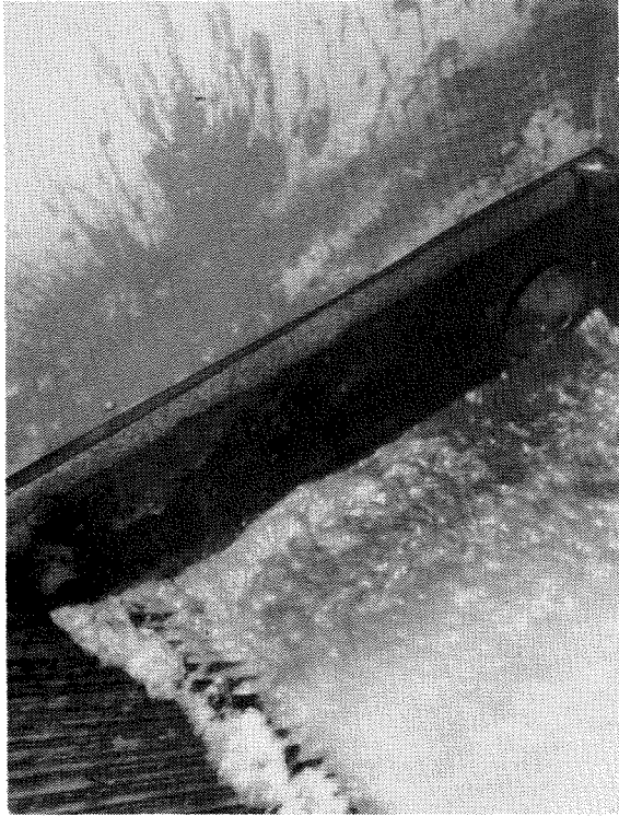
Innløpsrør med rist
