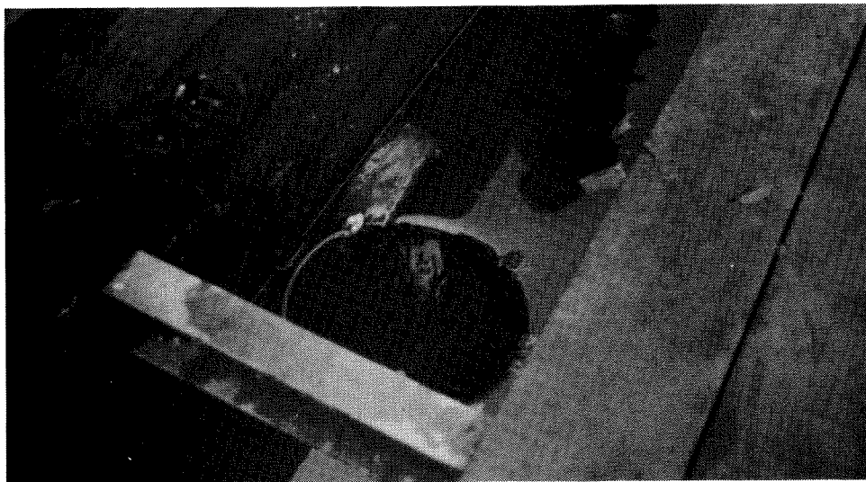
Detalj av flyteslam-avdraget i sedimenteringsbassenget.
