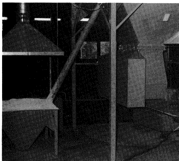
Utsyr for kalk dosering. Kalken tømmes i trakten til venstre, skrus opp i silo til høyre og doseres derfra til slammet.
