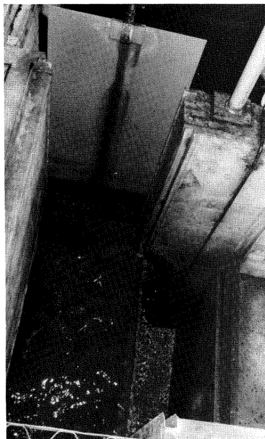
Tilløpsrenne med overløp til høyre
