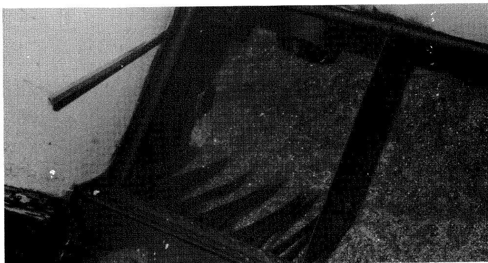
Rist. En ser at en del av stavene er bøyet til siden: Risten er lite effektiv.
