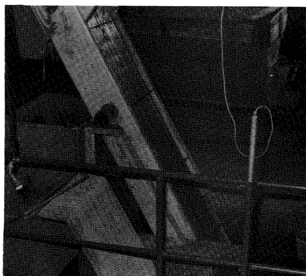
Maskinrenset rist. I bakgrunnen ses sugefilterpresse.
