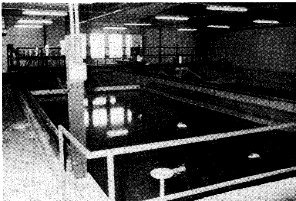
Interiør, en ser spor av akkumulert slam i sedimenterings-bassenget.
