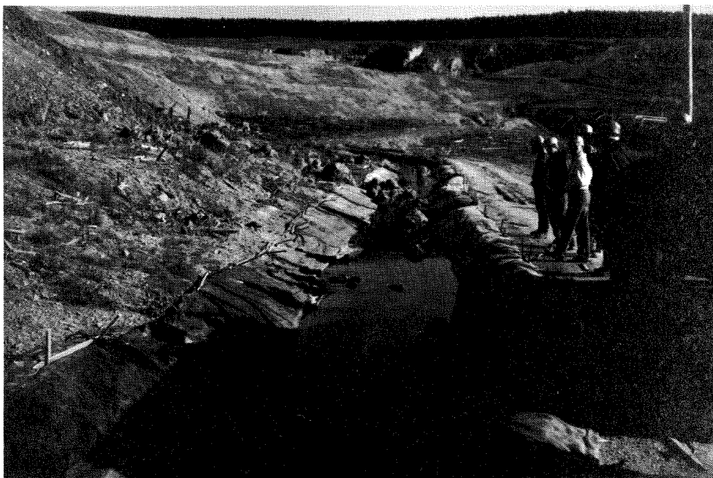
Fig. 5. Renner for oppsamling av surt drensvann ved Equity Silver Mine.
