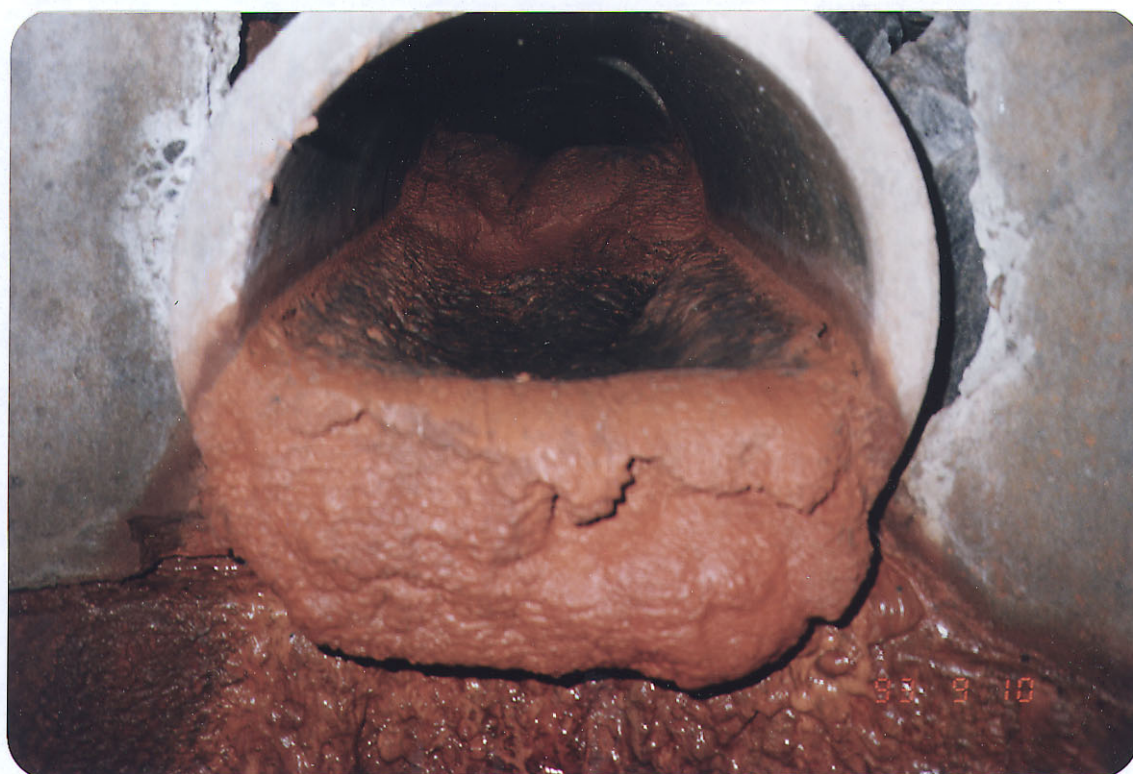
Foto 3.2. Solheim St. 3: Innløpsrør til St. 4 ved Haukelandshallen, 10.09.93
