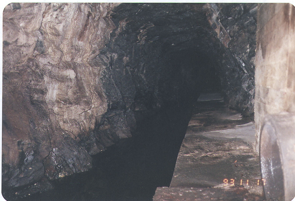
Foto 3.5. Overvannsledning til Tveitevann; St. 14 og 14A. Tunnel mellom Mannsverk og Nordahl Rolfsens vei, under området til Bergen Sporvei.
