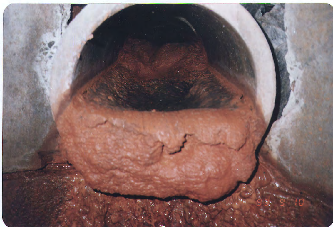
Foto 3.2. Solheim St. 3: Innløpsrør til St. 4 ved Haukelandshallen, 10.09.93
