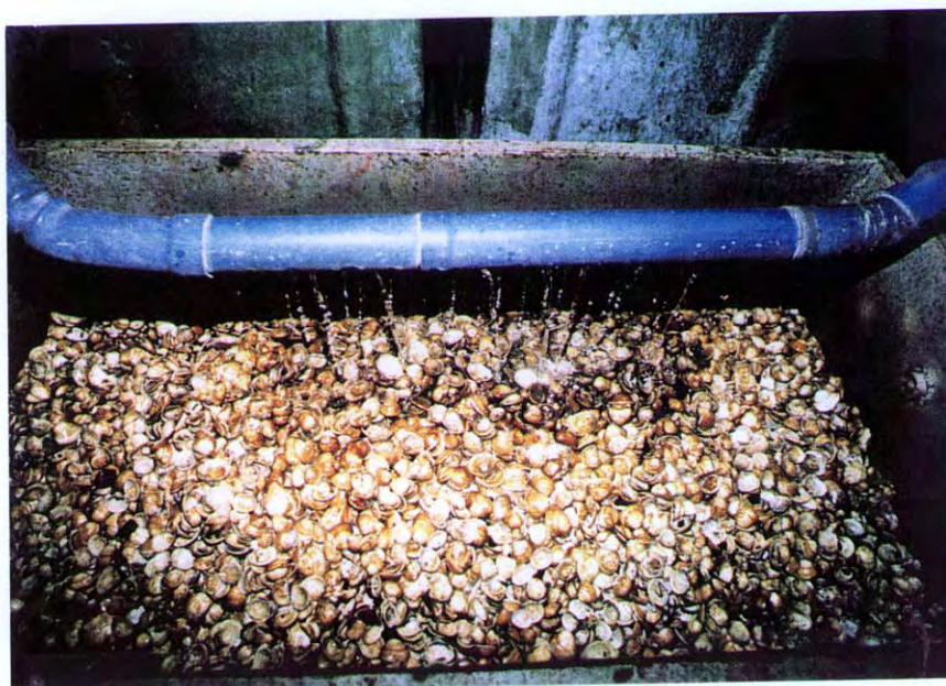
Figur 8 Vannet filtreres og renses gjennom et biofilter av muslingskall.
