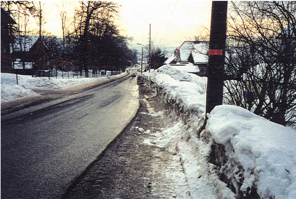
Figur 2. Grefsenkollveien etter fresing av brøytekanten.
