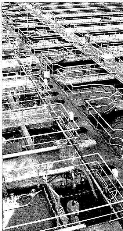
Rensing av avløpsvann ved Bekkelaget i Oslo.
