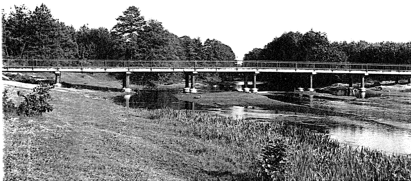
Most prefabrykowany systemu "Poltegor" (rzeka Świder, nośność 30T, L=80 m). Inwestor - WZDiM - Otwock
