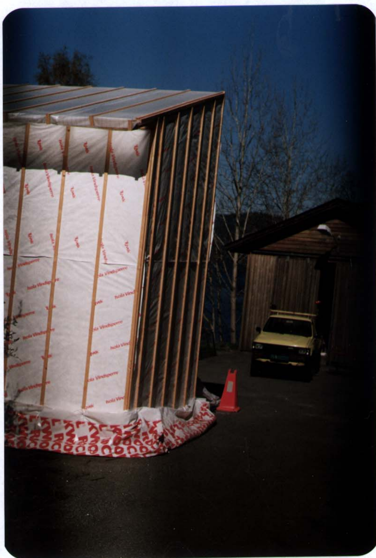
Figur 3: Pilotanlegget plassert og bygd inn på Gopledal vannverk.
