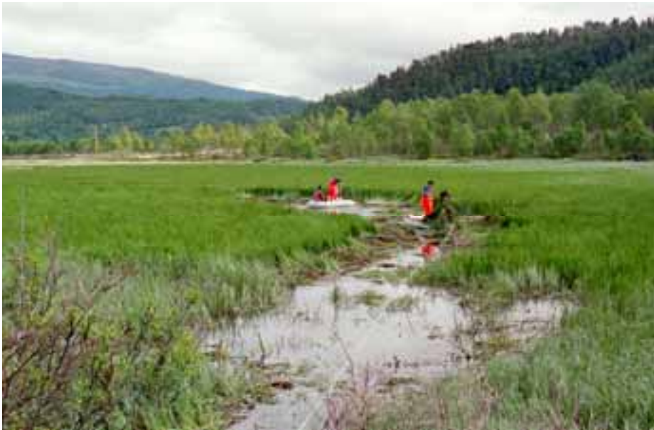
Figur 20. Et prøvefelt i elvesnellebeltet nedstrøms Djupvika ble ryddet sommeren 2001. Det ble her lagt ut 3 typer av geomembran med overdekning av pukk.
