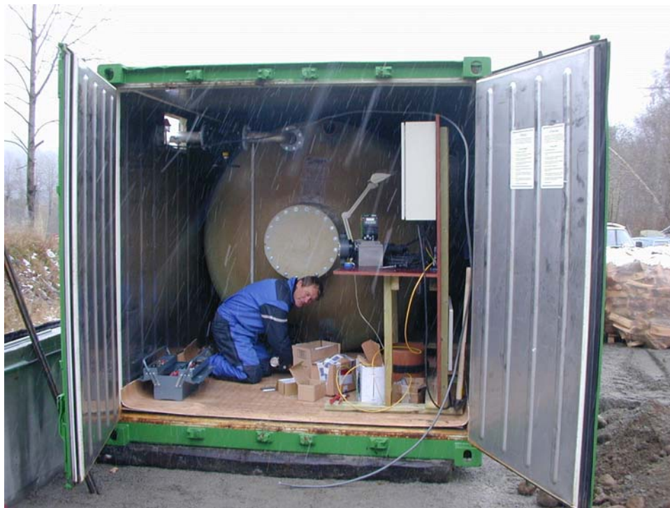
Figur 29. Foto av anlegget i Logåna som viser den ytre kjølecontaineren, styringsenheten og den indre silikattanken.
