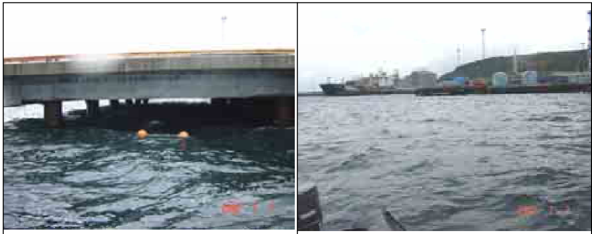
Figur 1. Plassering av Rigg M under Modulkaias østre kant.
