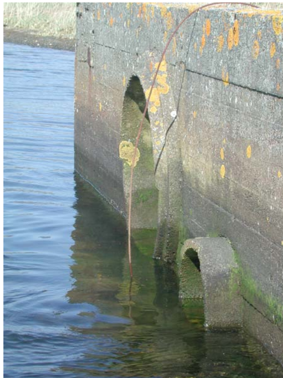
Figur 12. Nærbilde av Søndre kulvert med begroing.
