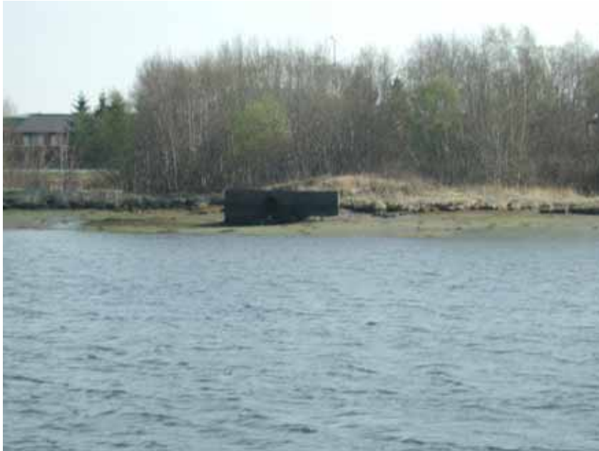
Figur 11. Oversiktsbilde fra området rundt Søndre kulvert for utløp av overvann fra rullebane og flyoppstillingsområde.
