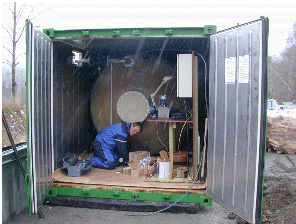
Figur 20. Foto av silikatdoseringsanlegget i Logåna (Mandalsvassdraget) som viser den ytre kjølecontaineren, styringsenheten, den indre silikattanken.
