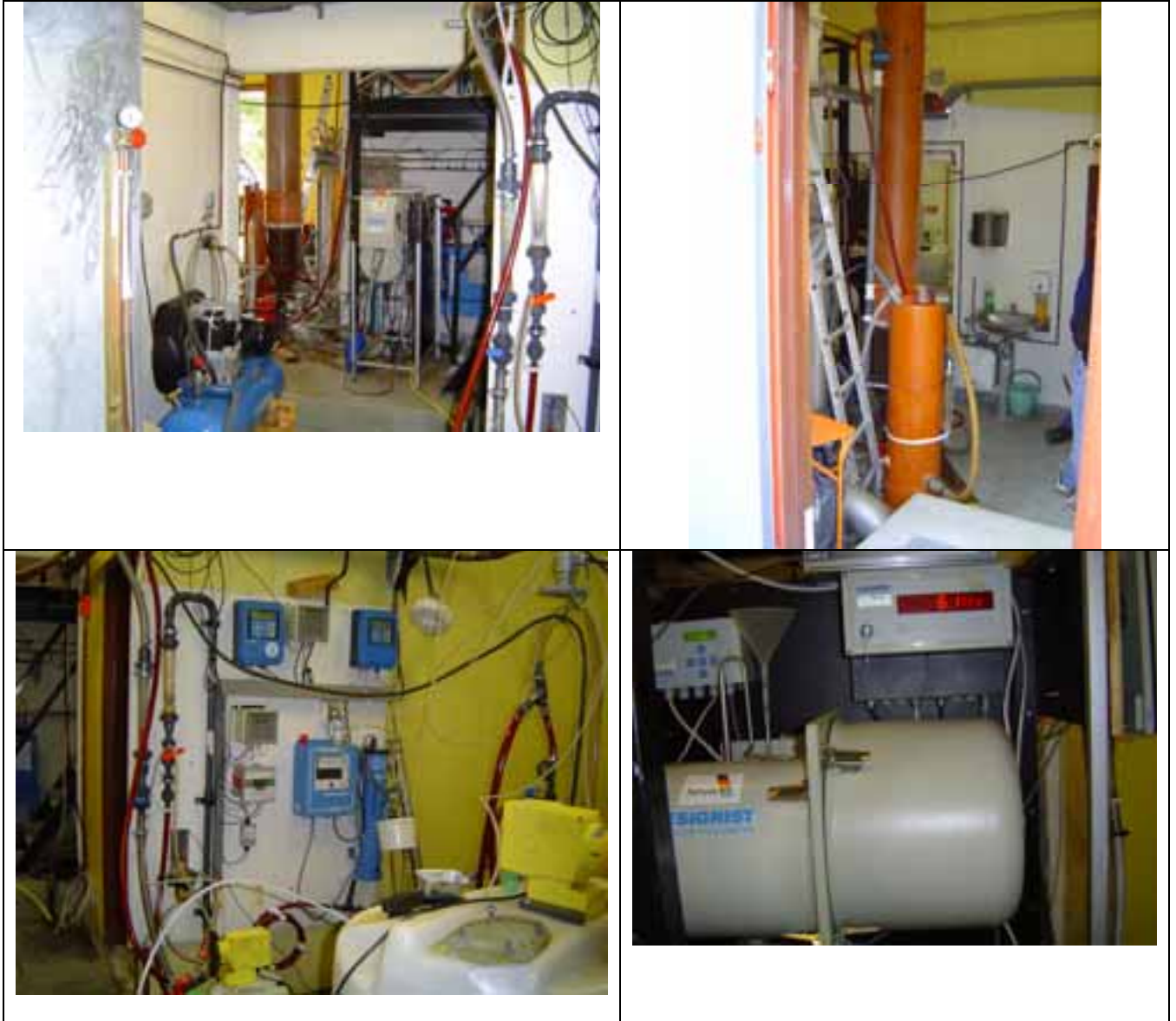
Figur 4. Foto av pilotanleggets plassering i vannverket med laveste oppnådde farge vist på fargemåleren nederst til høyre.
