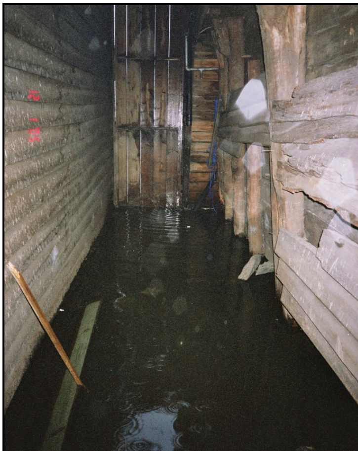
Figur 10. Fotografi frå dråpefallet ved nordsida av Bredsgården under springfloa 12. januar 2005. fotografiet er tatt bakfrå, i retning Vågen. Vannstanden i bygningsfronten var ca ½ m. Ein av NIVAs måleinstrument (posisjon C, SD200 sonde) var plassert her.
