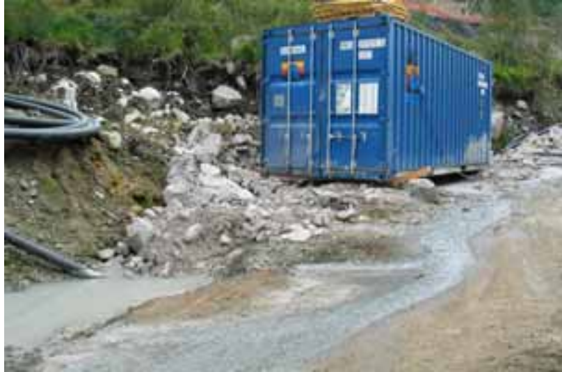
Bilde av container som inneholdt 8 MAPEQUICK tanker. Utslippet var på utsiden av denne.
