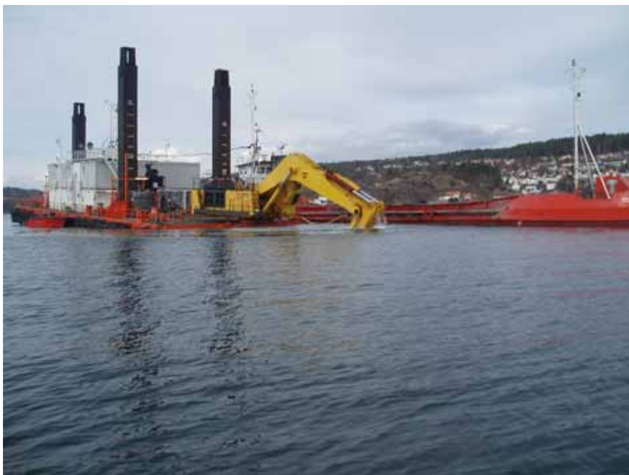
Bildet viser graving av leirholdige masser ved Småskjær 14/04-05 med den kombinerte grave og transportlekeren "Transport 052" og splittlekeren "Mudder-079". Foto: John Arthur Berge.
