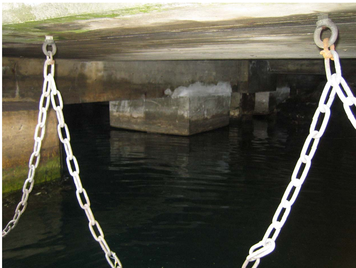
Figur 24. Fotoet viser undersiden av Kommunekaia. Prøver ble innsamlet som blandprøver dels på de eldre delene av konstruksjonene og de nyere delene av kaia.
