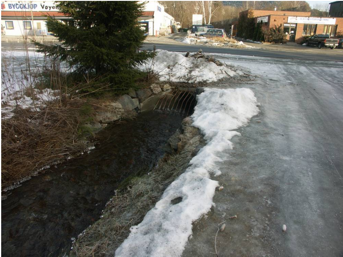
Figur 50. Stovibekken ved inntaket for røret som er lagt under E16 ned til Isielva. Inntaket tetter seg ofte med kvist etc. og fører til lokal flom. Dette har nok vært tilfellet noen dager før bildet ble tatt. På snøfonna midt i bildet ligger det mye ”rekved” som er fjernet fra inntaksgitteret.
