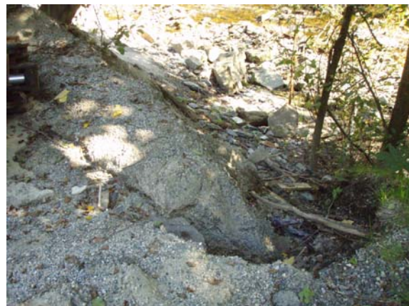
Erosjon i kanten
