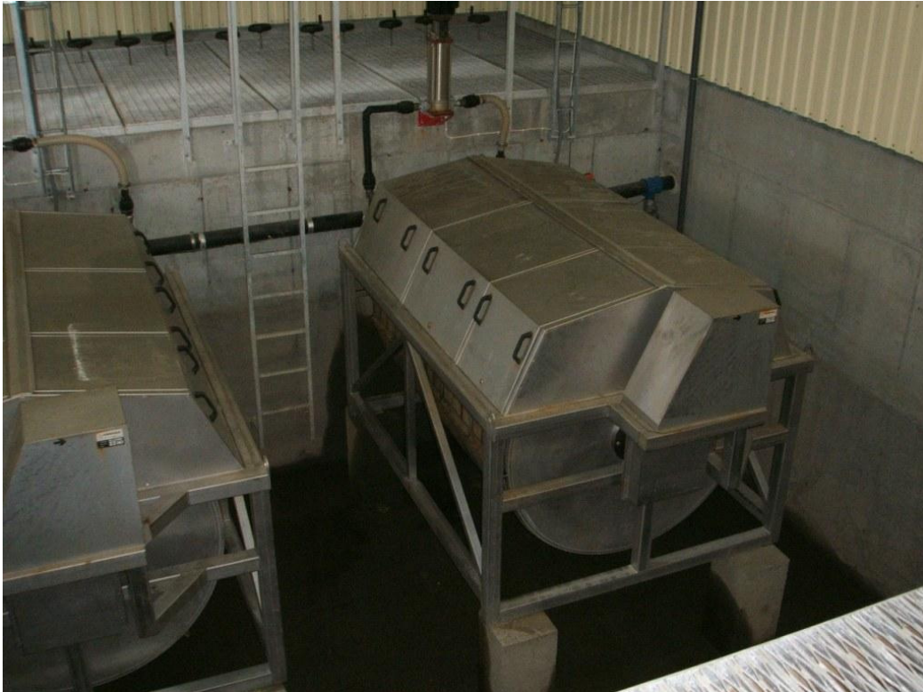
Figur 3. Avløpsfilter som sekundærsikring
