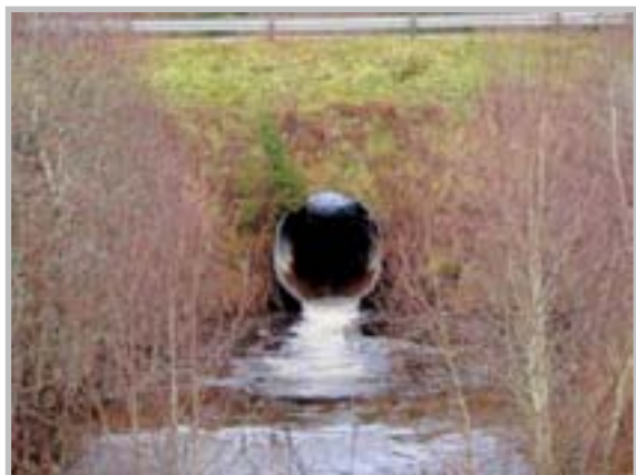
Figur 27: Kulvert under RV 12 i Kvitnesbekken., med vannføring over middels (Foto M. A. Bergan).
