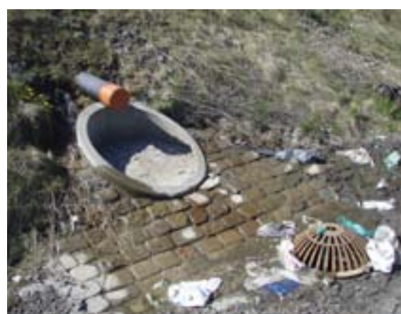
Overløpsrør avstengt, vegkum med rist
