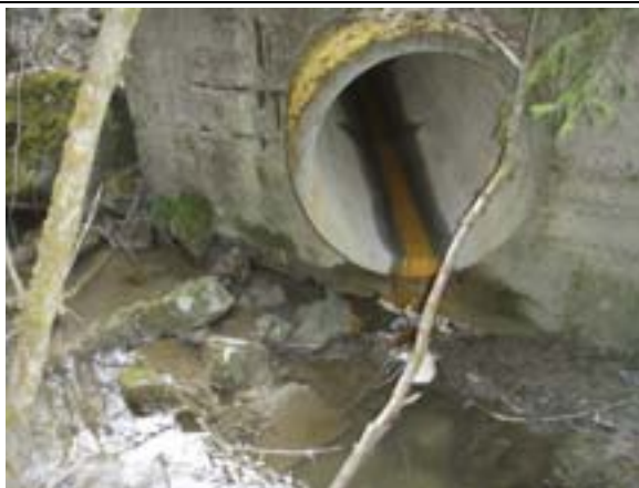
Rør under vegen fra område ved snødeponiet
