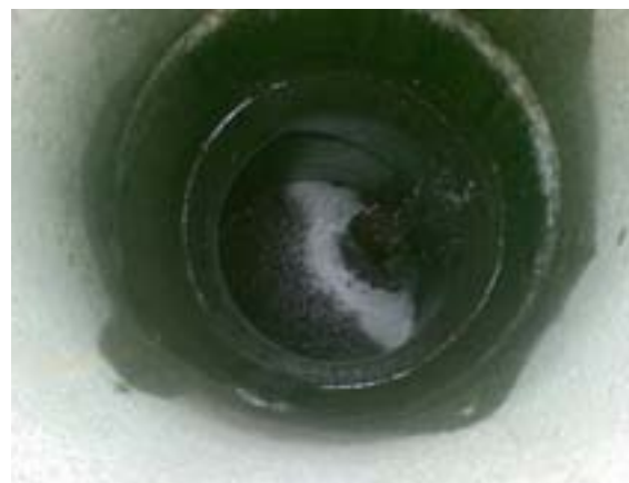
Kum nord med overløpsrør og innlekking
