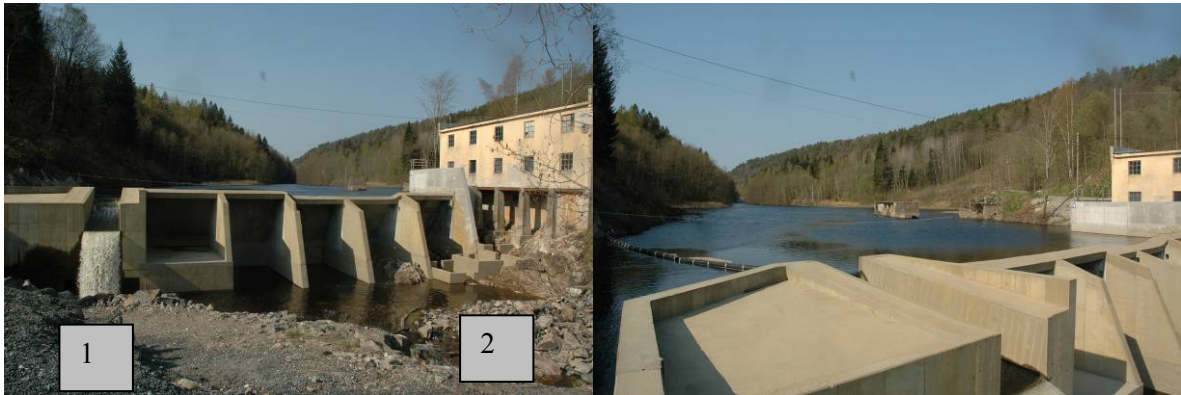
Figur 9. Illustrasjon av kraftverksdam (venstre) og plassering av sperrenot (høyre). Nota er trukket fra damkrona til åskanten bakover. Mens nota var operativ gikk det vann i rensekanal samt i laksetrappa. Disse stedene er antydnet med tallene 1 og 2.
