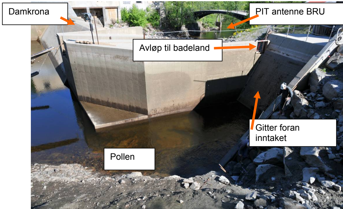
Figur 20. Bilde av pollen foran inntaket til kraftverket. I bildet sees gitteret foran inntaket til turbinen samt avløpsluka til badeland.
