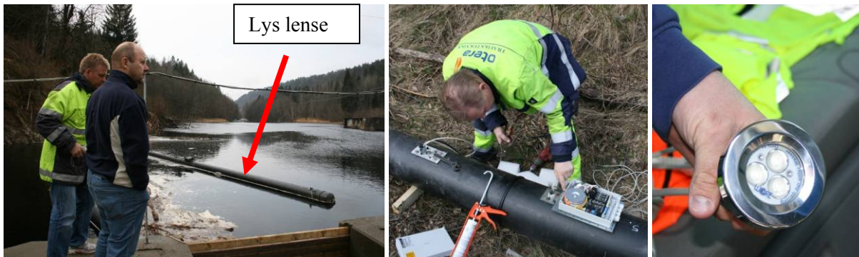
Figur 6. Plassering av LED-lyssperre benyttet ved Fosstveit kraftverk i 2010. Bildene til høyre viser selve LED-armaturen og innmontering i rør. Foto: Lars Tormodsgard.
