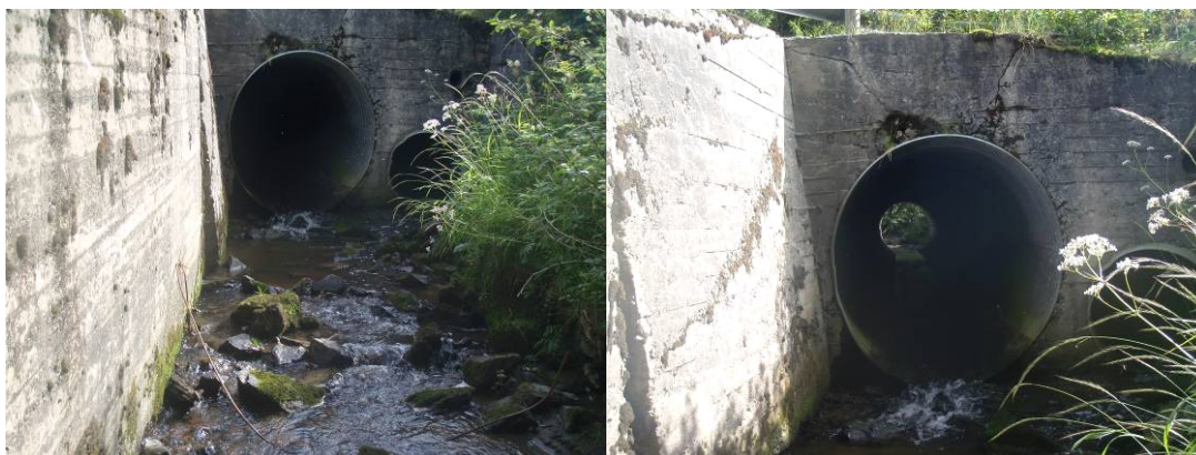
Foto: Kulvert oppstrøms stasjon 1a, under FV855, i Solemsbekken, der punktutslipp vises på bildet til høyre på hvert bilde. Kulverten kan være vandringshindrende etter Kriteriesett A.
