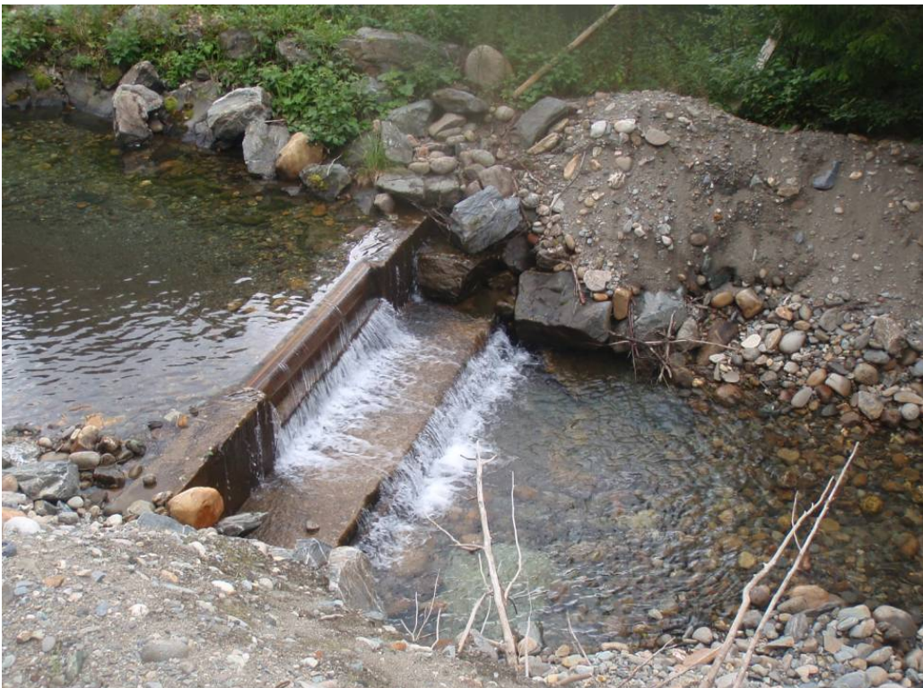
Foto: Betongdemningen i Kaldvella som ikke oppfyller krav til frie vandringsveier etter kriteriesett A.
