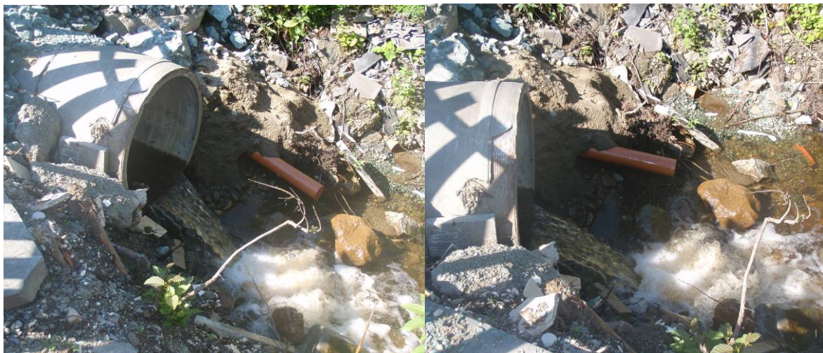
Foto: Kulvert ved Svingen og Lundamo skole og barnehage er vandringshindrende etter kriteriesett A.
