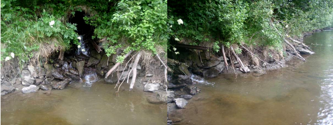
Foto Nedre kulvert i Mjølkhusbekken, som danner permanent vandringshinder for oppvandrende Nidelvørret.
