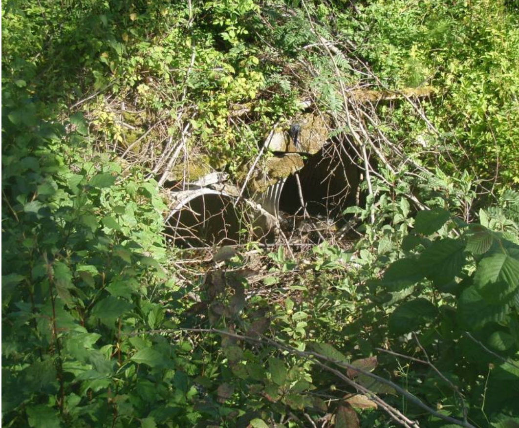
Foto: Kulvert under navnløs grusvei som går parallelt med Stor-Tronds vei, der bekken også går i kulvert. Kulverten er vanskelig å vurdere etter kriteriesett A, og vandringsmulighetene for laksefisk er usikre.
