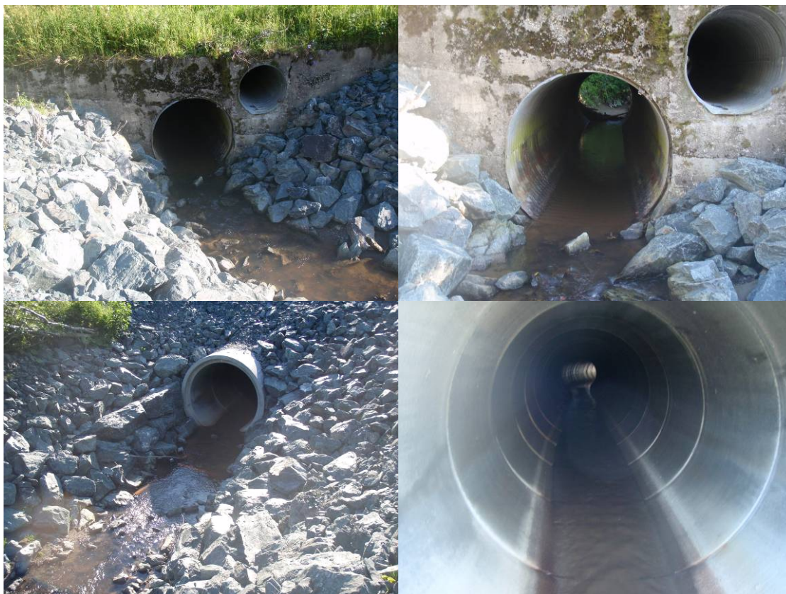
Foto: Gammel (øverste bilder) og nyanlagt kulvert (nederste bilder) i steinsatt strekning av Solemsbakkens nedre deler. Den nye kulverten (nederst) har ugunstige vandringsmuligheter for laksefisk ved lav vannføring, og det er noe usikkert om den er mindre problematisk i perioder med større vanngjennomstrømming. Kulverten er trolig vandringshindrende etter Kriteriesett A.
