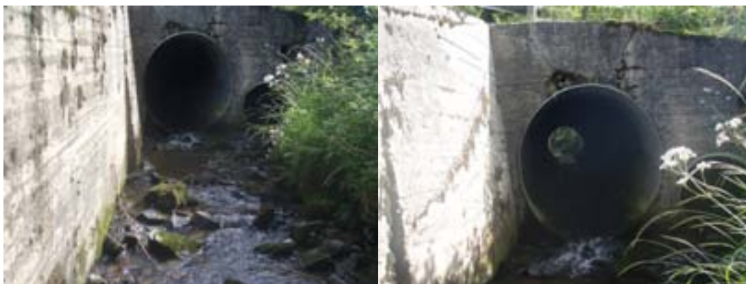
Foto: Kulvert oppstrøms stasjon 1a, under FV855, i Solemsbekken, der punktutslipp vises på bildet til høyre på hvert bilde. Kulverten kan være vandringshindrende etter Kriteriesett A.
