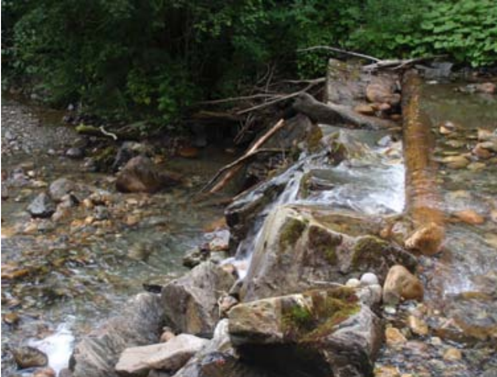
Foto: Menneskeskapt vandringsbarriere som ikke tilfredsstillter kriteriesett A i midtre avsnitt av Kaldvella. Det er bygd en foss /terskel med høyt sprang, og anadrom laksefisk kan ikke passere.
