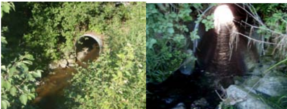
Foto: Kulvert der Solemsbekken munner i Amundbekken.
