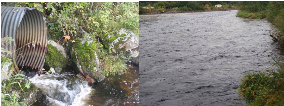
Foto: Sprang opp til kulvert selv når Orkla går med vannføring over middels på undersøkelsestidspunktet.
