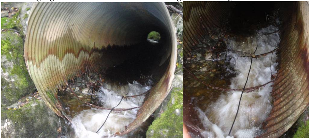
Foto: Utløp av kulvert til Orkla. Vanskelige oppgangsforhold i kulverten, der bunnen av kulverten er delvis ødelagt. Små muligheter for oppgang med mindre Orkla går flomstor, og vann stuver opp i kulverten.
