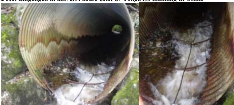
Foto: Utløp av kulvert til Orkla. Vanskelige oppgangsforhold i kulverten, der bunnen av kulverten er delvis ødelagt. Små muligheter for oppgang med mindre Orkla går flomstor, og vann stuver opp i kulverten.
