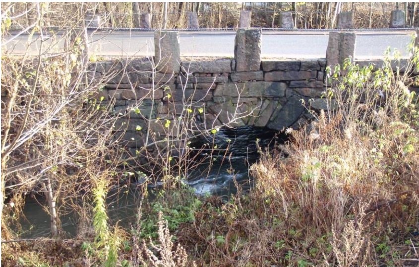
Foto: Tilfredstillende veikrysning (og gammel) under Kalbakkveien nedstrøms ALN2, der bekkesenga er bevart og kulverten er like bred som naturlig elveleie.
