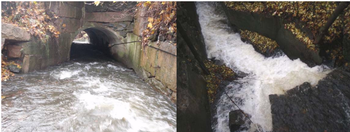
Foto. Elveavsnitt ved kryssing av Slemdalsveien, hvor antropogene inngrep ikke er utført i henhold til krav om å bevare kontinuitet for fiskevandring. Et overheng (til høyre) av menneskeskapt materiale skaper for høyt fall i forhold til det naturlige fallet, og hindrer evt oppvandring av fisk i alle aldersklasser innad i avsnittet.
