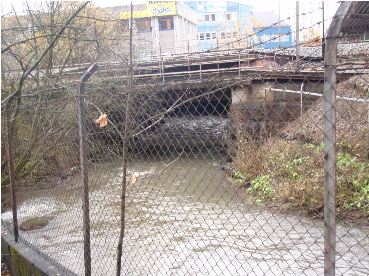
Foto: Stasjonsområdet ALN5, med kulvert under jernbane. Jernbanekrysningen er godt utført i forhold til kontinuitet for fisk, der elvebunnen er bevart i forbindelse med krysningen.
