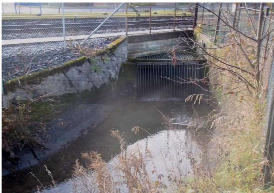
Foto: Kulvert nedstrøms HOV2, der Hovinbekken går i bakken en lengre strekning.
