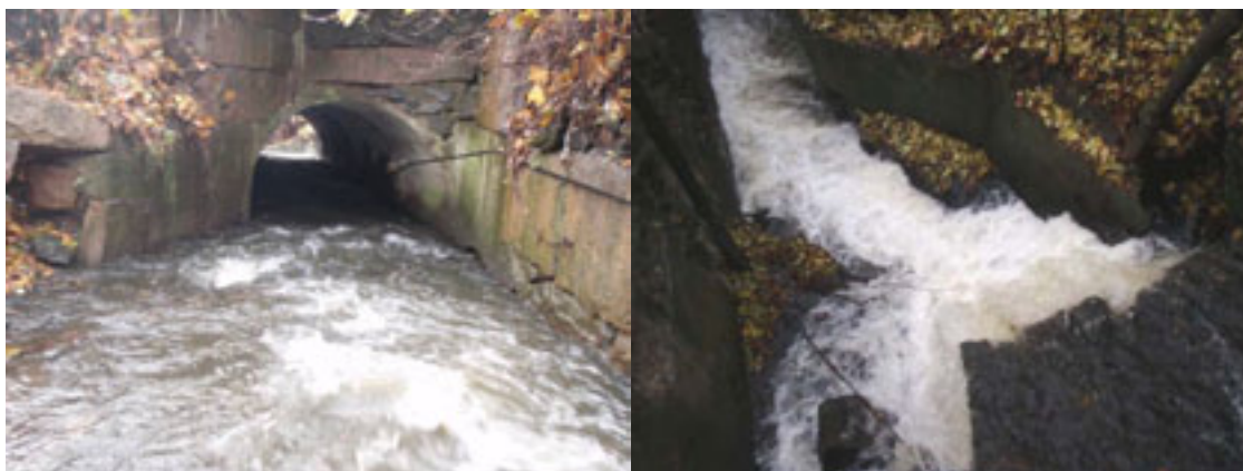
Foto. Elveavsnitt ved kryssing av Slemdalsveien, hvor antropogene inngrep ikke er utført i henhold til krav om å bevare kontinuitet for fiskevandring. Et overheng (til høyre) av menneskeskapt materiale skaper for høyt fall i forhold til det naturlige fallet, og hindrer evt oppvandring av fisk i alle aldersklasser innad i avsnittet.
