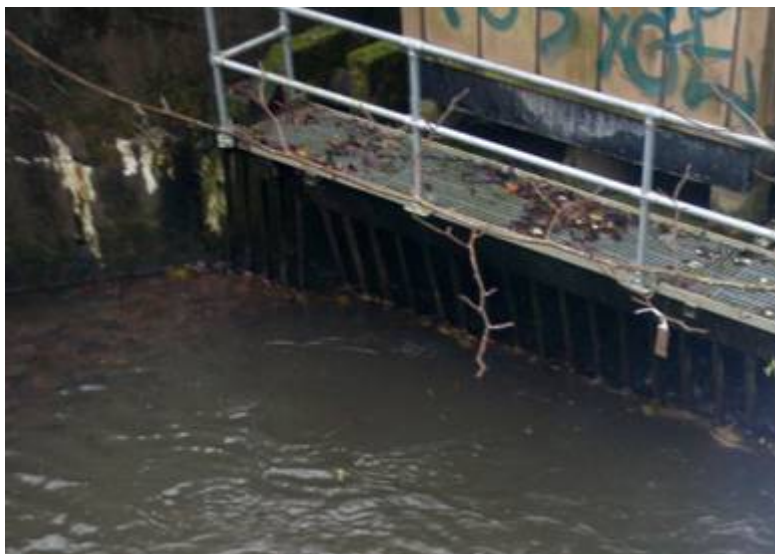
Foto. Inngangen til kulvert i nedre del av Frognerelva. Kulverten er stor, godt nedsenket og har uproblematisk helning og vannhastighet, men ristene i åpningen må holdes ved like i forhold til tilstopping og tetting.
