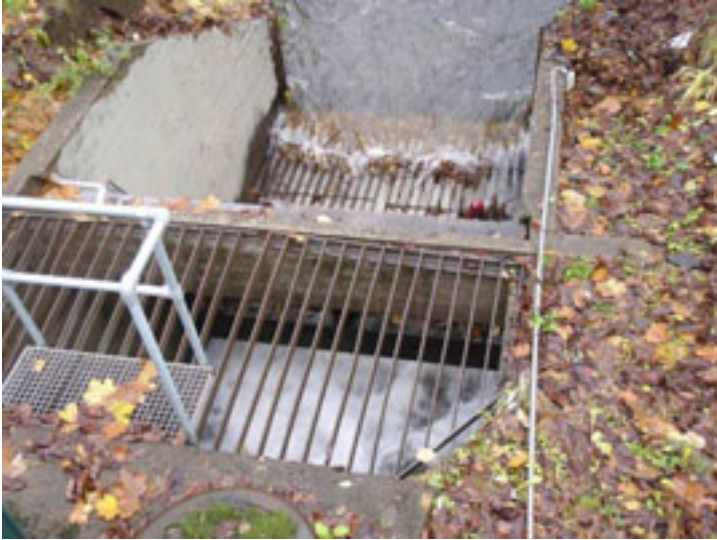
Foto. Rist foran innløpet til kulverten hindrer oppvandring, og er i tillegg tilstoppet av løv og trevirke.
