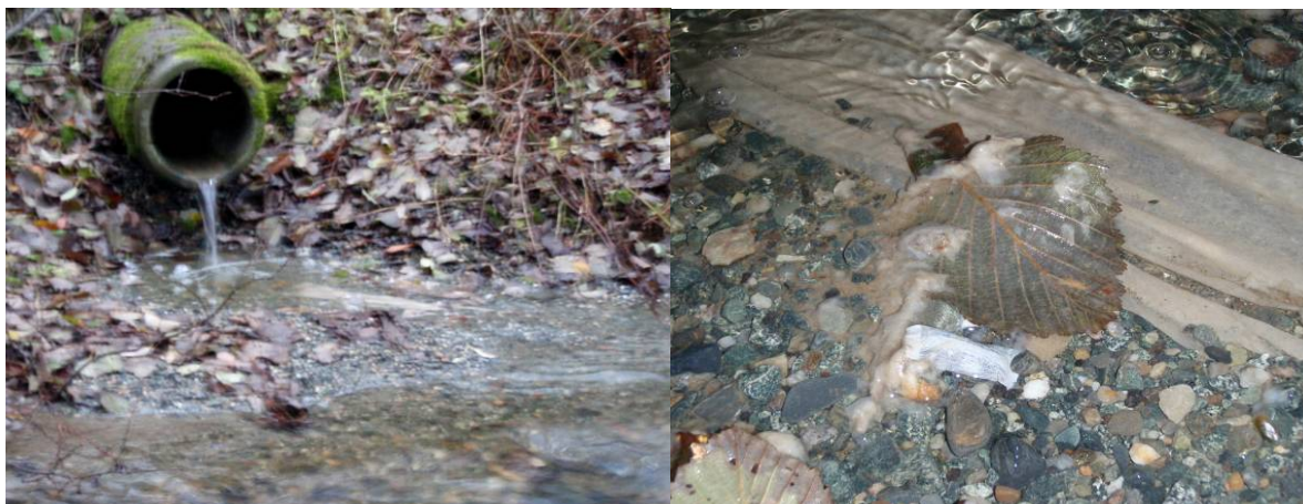
Foto: Punktutslipp av sanitært avløpsvann (kloakk) i Flakkbekken/Råbekken, med toalettpapir og diverse sanitært avfall nedstrøms røret. Røret kommer fra et lite antall husholdninger, og har foreløpig ikke gitt redusert økologisk tilstand målt ved bunndyrsamfunnet i vassdraget.
